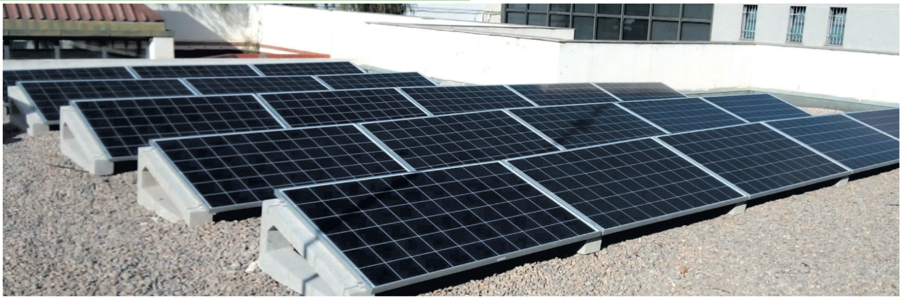
Imatge del terrat d'Asivalco amb les plaques fotovoltaïques. //LCTG
